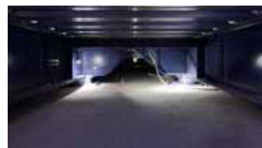
写真 13 展示室下部の免震層
